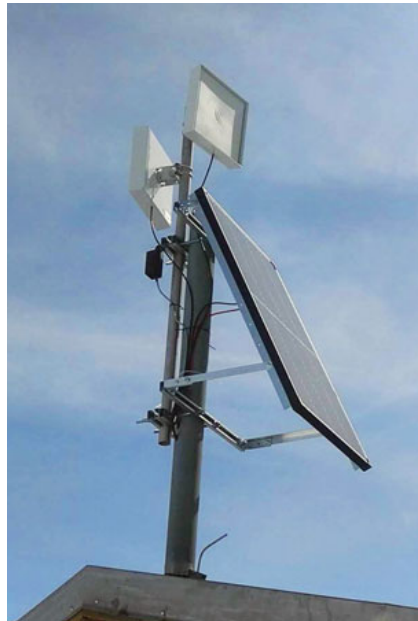
oben: PV-Panel mit Link-Antennen
