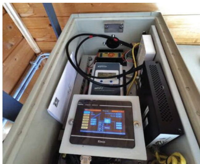
Schaltschrank Hamnetknoten Gueser Kopf
