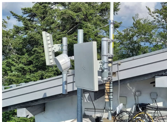
LTE-Antenne (rund) und HAMNET-Planarantennen am Dach der Bergstation. Die rechte Planarantenne zeigt Richtung DB0WV. Die linke Antenne ist für Benutzer-Anbindung via HAMNET vorgesehen und zeigt Richtung Bregenz/Hörbranz. Der „Kabelsalat“ im Hintergrund stammt nicht von OE9XKV ;-) Foto: OE9BKJ
