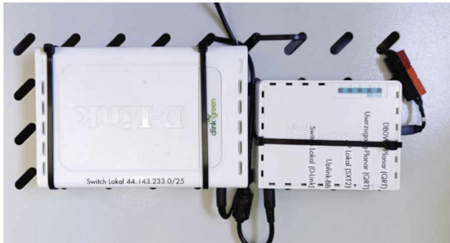
Die beiden Switches im Rack. Rechts ein Mikrotik-Switch mit PoE-Ports und links eine Port-Erweiterung über einen normalen D-Link Switch. Foto: OE9BKJ
