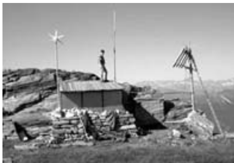
Die Relais­hütte am Speiereck mit Windgenerator und Antennenanlage...
