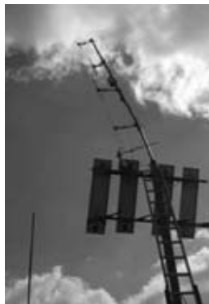
...die Antennenanlage von unten ... muss sehr starken Stürmen trotzen.
